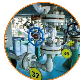
Stacja uzdatniania wody
